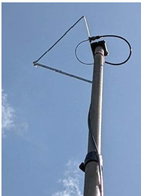
Foto 4.3.3. Anténa namontovaná na stožáru
